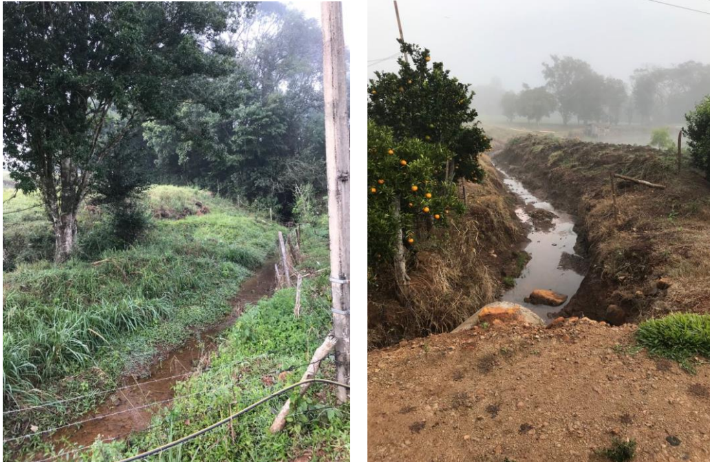
Figura: 16: Drenagem identificada no ponto 2.
