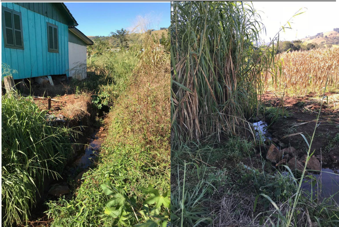
Figura: 66: Vala de drenagem ao lado da casa atingida por alagamentos.
