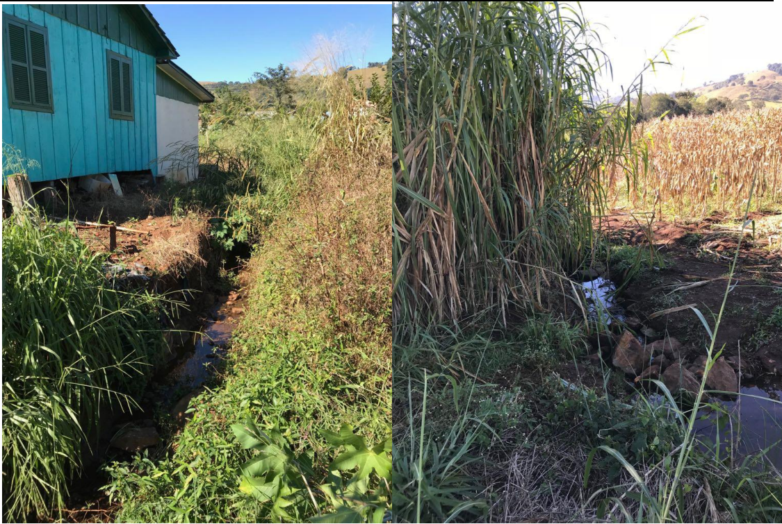
Figura: 27: Vala de drenagem ao lado da casa atingida por alagamentos.
